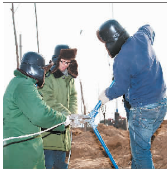
连日来,为保证农网升级工程早日竣工,淇县供电公司组织员工对全县2012年农网升级工程进行全面冲刺。图为12月24日,工作人员冒着严寒在鹤壁产业集聚区架设10千伏线路。左华军 摄
