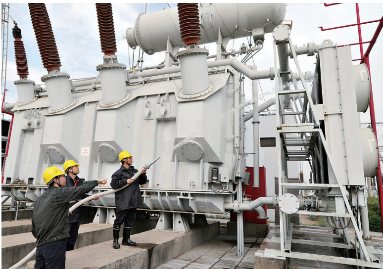
供电公司运维人员手持高压水枪为主变压器冲水降温 桑萍 摄
