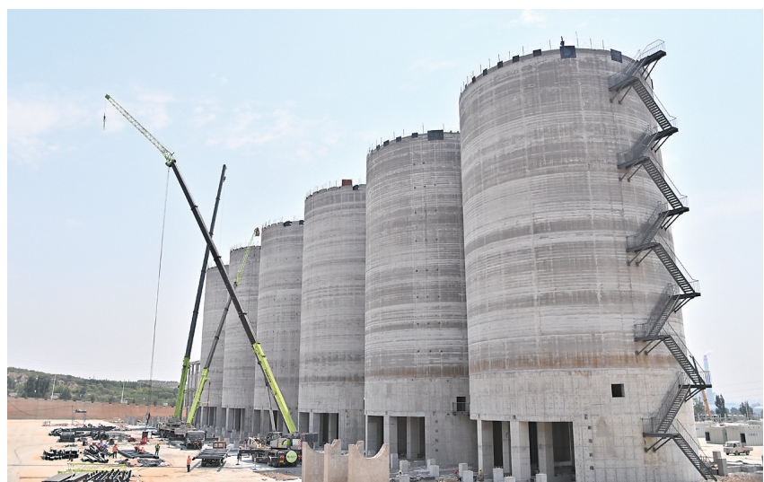
6月18日,鹤壁镁基新材料综合利用产业基地项目建设现场,为确保项目如期交付,工人们坚守岗位紧张施工作业。 本报记者 张宁 摄
