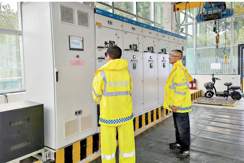
淇滨区市政抢险人员检查排涝泵站运行情况。
