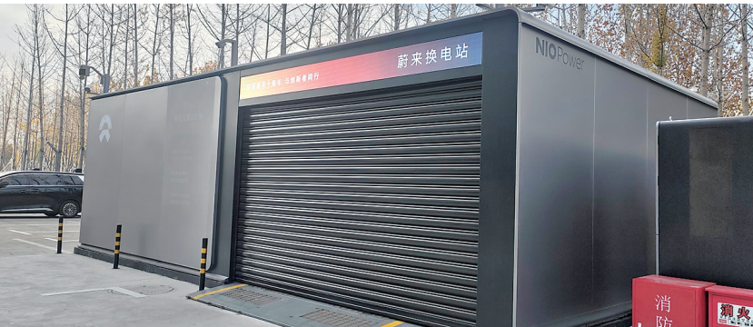
蔚来汽车鹤壁城市体验店的换电站
