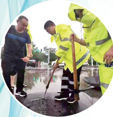
市政人员排查窨井盖安全隐患
