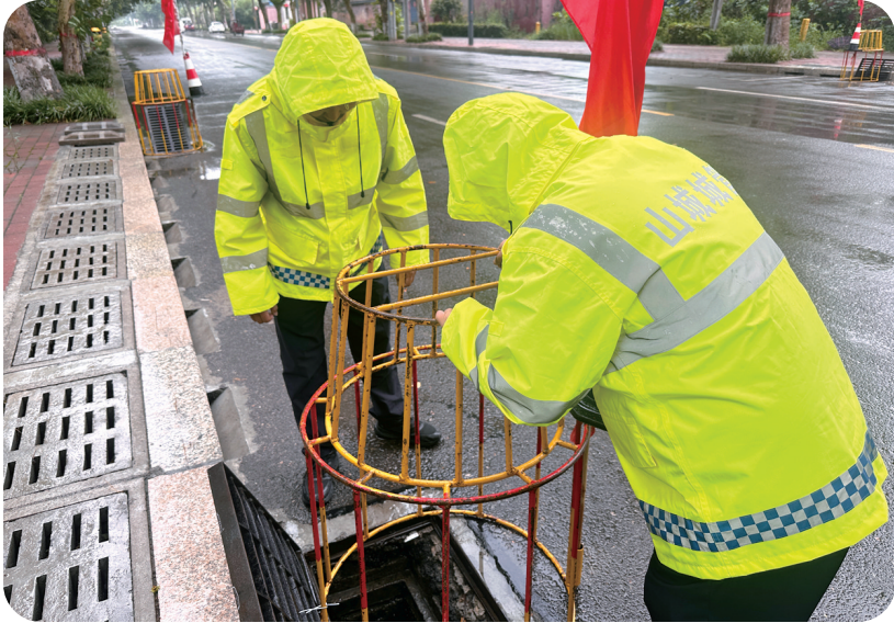
城管部门工作人员在低洼路段雨水井设置安全警示范,对排水通道开展巡查排查,并安排人员现场值守盯防,有效防范坠坑、涉水等险情,守护群众出行安全。 山城区城市管理局供图
